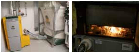
Innovative Anlagentechnik ist Teil eines jeden Passivhauses.
