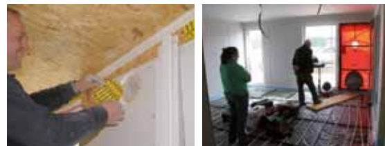
Luftdichtheit ist für die Energieeffizienz entscheidend und wird mit dem „BlowerDoor-Test“ geprüft.
